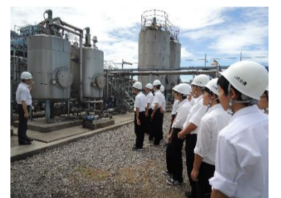
バイオエタノール製造所
